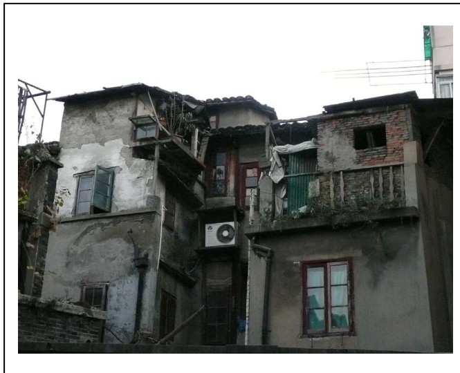
Photo 4 : Les maisons délabrées du quartier
